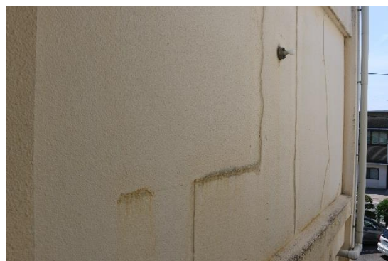
↑ 外部壁のひび割れ状況
