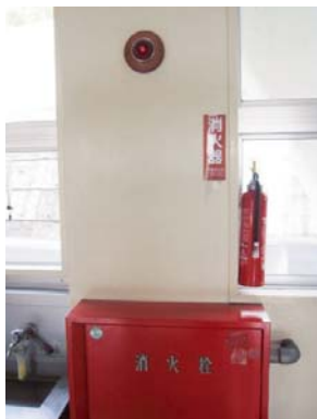
【消火栓と消火器】
